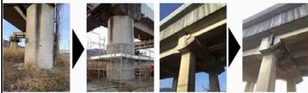
福島～白石蔵王間 高架橋柱損傷
