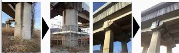
福島～白石蔵王間 高架橋柱損傷
