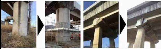
福島～白石蔵王間 高架橋柱損傷
