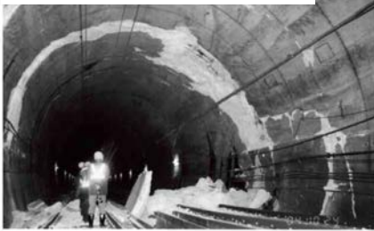
写真-3 地質不良区間での被害例 (魚沼トンネル)
