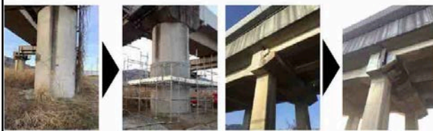
福島～白石蔵王間 高架橋柱損傷
